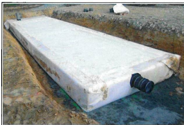
Figure 2 : Réservoir de stockage
